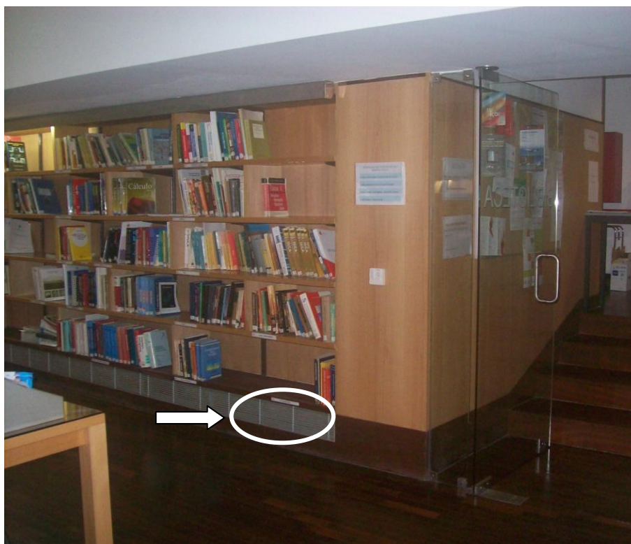
Figura 15. Secção da grelha de extracção da sala de leitura da BEC.
