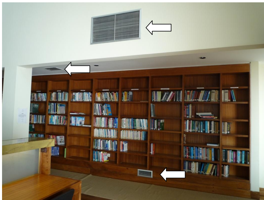
Figura 16. Grelhas de insuflação e de extracção da sala de leitura da BEM.
