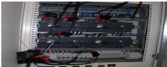
Figura 38 – Equipamentos de medição no quadro eléctrico QP-1N/E
