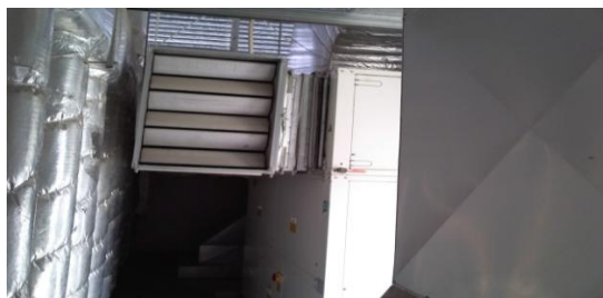
Figura 11 – Rooftop 1 instalada na zona técnica
