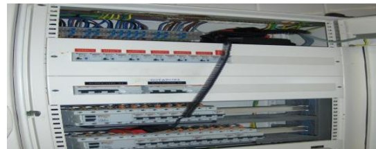
Figura 39 – Equipamentos de medição no quadro eléctrico QP-1.1N/E
