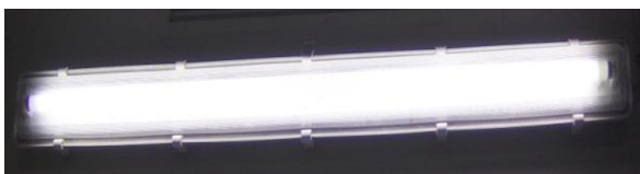
Figura 32 – Aparelho de iluminação equipado com lâmpadas fluorescentes lineares
