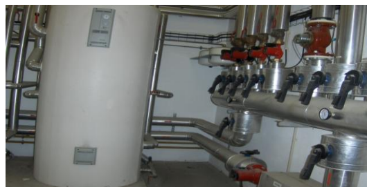
Figura 16 – Depósitos de acumulação de AQS
