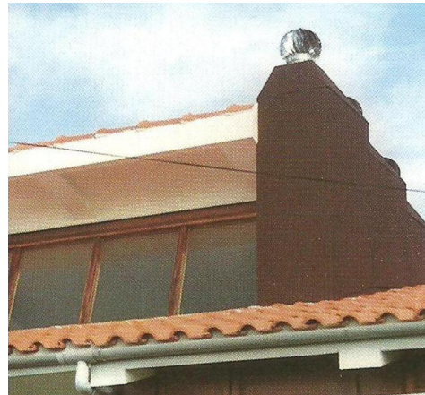
Figura 2.26 - Pormenor exterior de chaminé solar, Casa Sháfer, Porto Santo (Gonçalves, et al, 1997)
