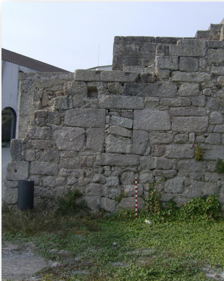
Fig. 100 - Área onde se evidenciam inúmeras perturbações ao aparelho construtivo do edifício monástico original Foto: Daniel Ribeiro
