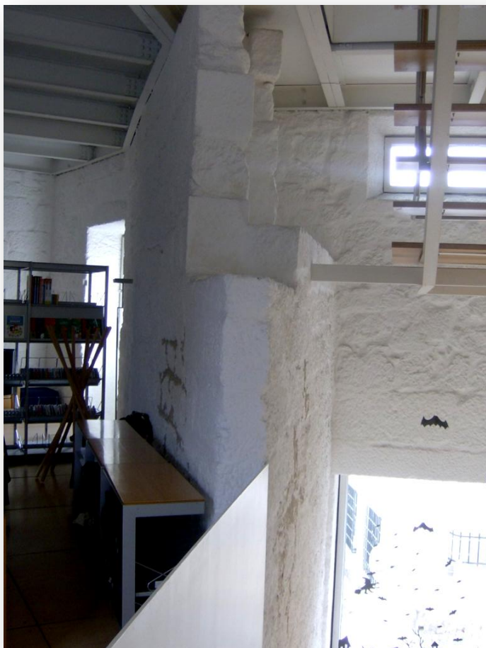
Fig.59- Pré-existências do mosteiro: Alçado de correlação entre as alas Sul e Oeste dos antigos espaços monásticos. Foto: Daniel Ribeiro
