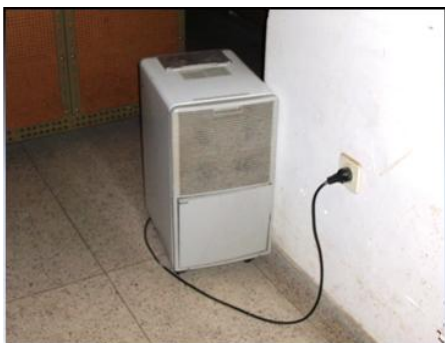
Figura 3.3: Desumidificador no depósito de periódicos.
