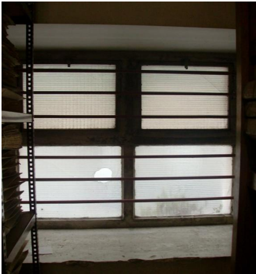
Figura C.5: Janela com o vidro partido no depósito de periódicos.
