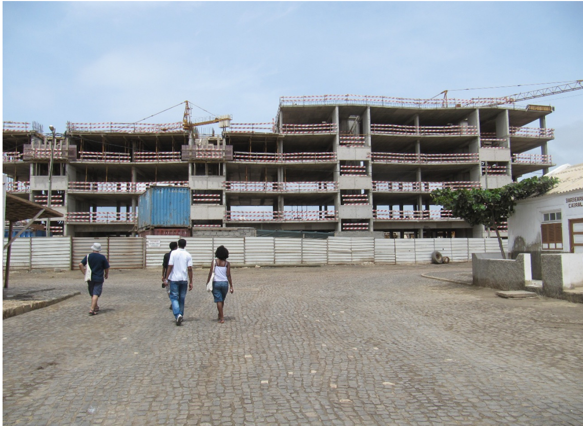
Edifício cuja construção se encontra parada no remate da rua de Salinas
