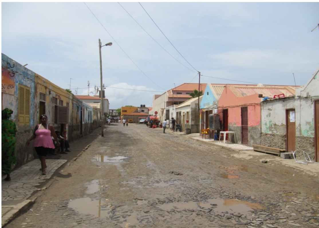
Rua de Ca' Tchicha onde o pavimento em calçada se encontra em estado degradado
