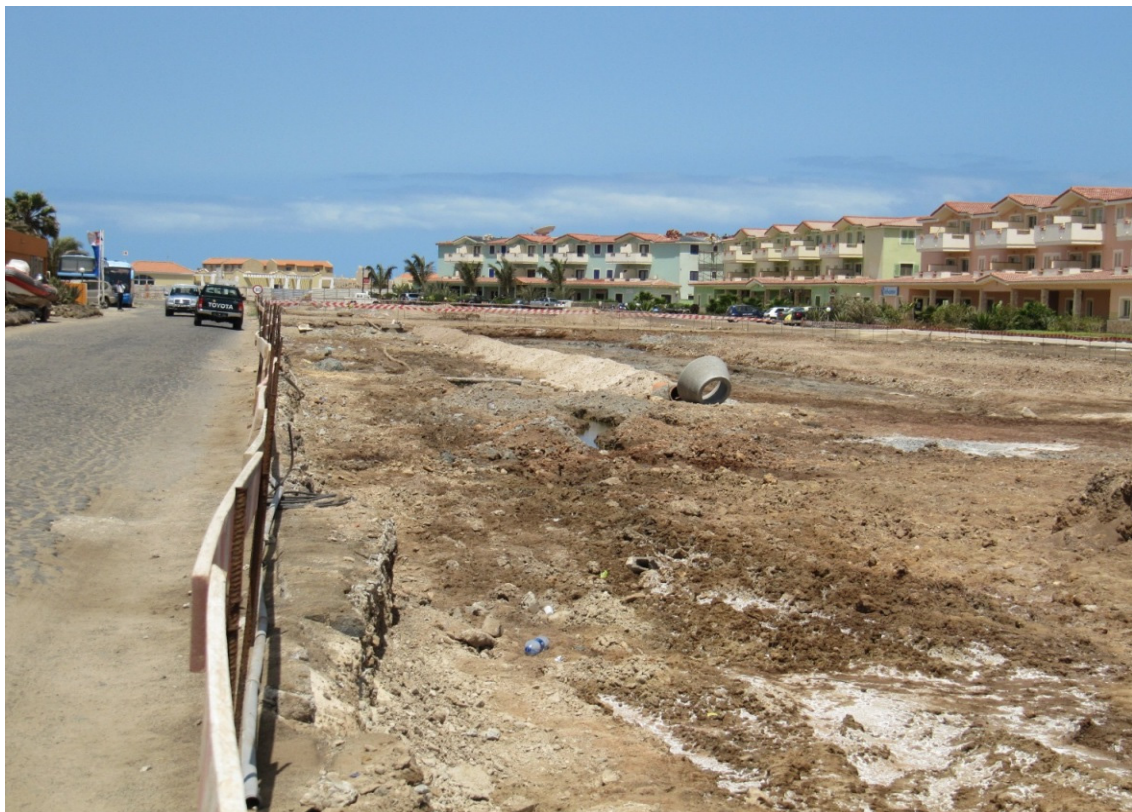
Arruamento de acesso automóvel aos hotéis situados a Oeste da cidade, com obra da urbanização construída no local da salininha, suspensa devido ao sal existente nos solos
