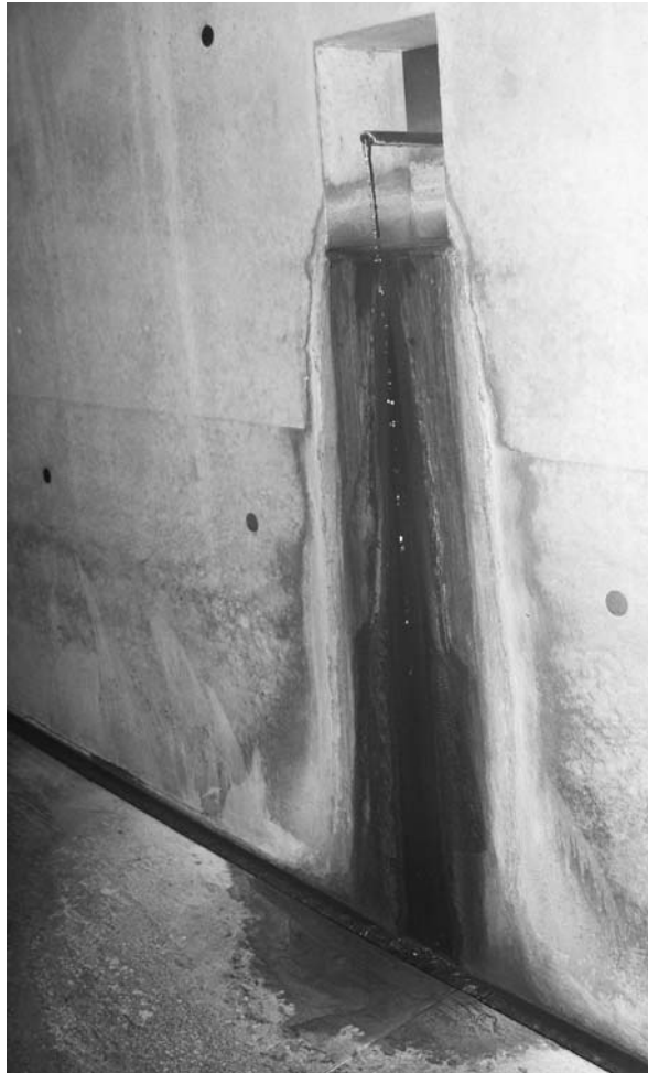
51| A humidade na parede de betão nas Termas de Vals de Peter Zumthor, 1996. Sentimos o tempo a passar, o edifício está vivo e envelhece.
