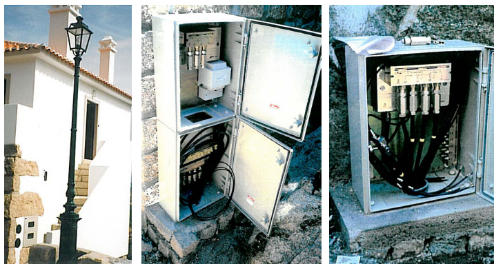
117. Infraestruturas eléctricas e TV
