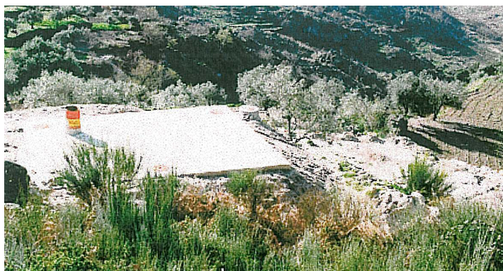
143. Infraestruturas públicas - emissário e fossa séptica
