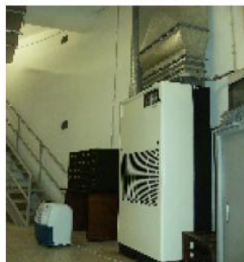
Figura 3.2: Unidades de tratamento de ar no interior da casa forte
