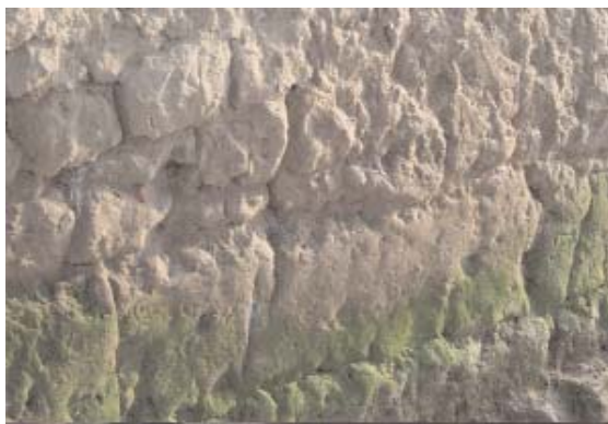
Fig. 54 - Trecho de parede sem reboco onde se distinguem os diferentes "tijolos" moldados e assentados à mão e sem argamassa.
