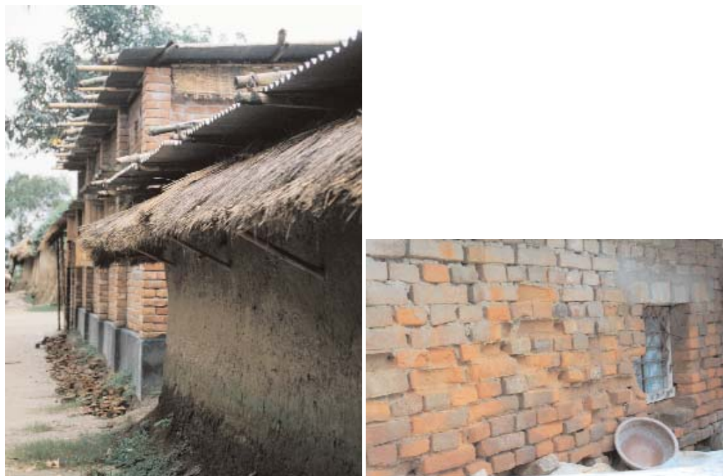
Fig. 56 - Modelo arquitectónico de fraca qualidade construtiva e que não se encontra em consonância com a paisagem construída local
