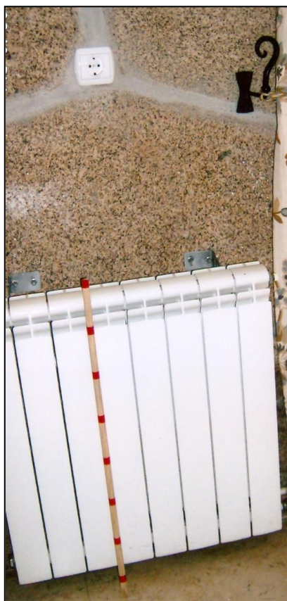
Foto 14- Tomada de electricidade distanciada a 1,20 cm do chão
