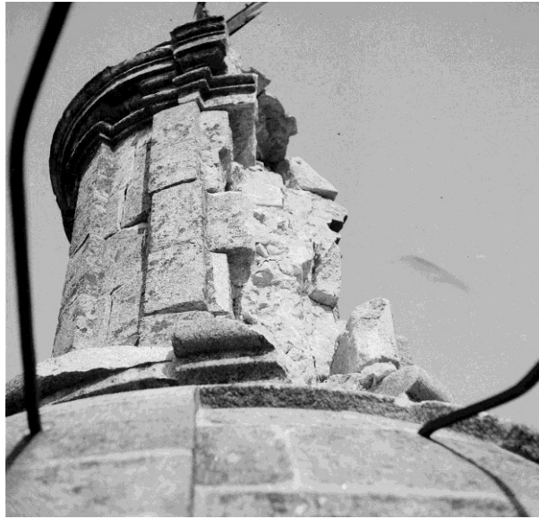
Fig. 22 – Foto das danificações provocadas pelo raio. DGEMN
