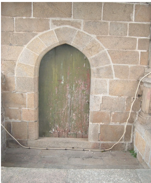
Fig. 6 – Porta de ligação da actual casa paroquial com o passeio dos cônegos.
