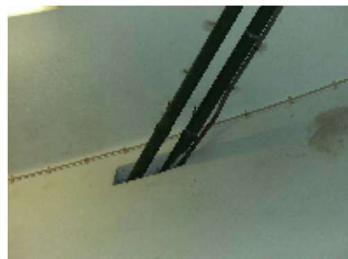
Imagem 16: Tubagens no Exterior da Casa na Forte
