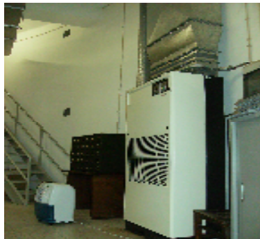
Imagem 7: Aparelhos higrótérmicos no Interior da Casa Forte
