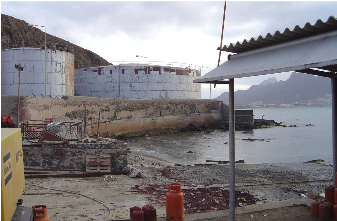
Vista de dois dos depósitos da Enacol
