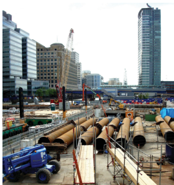
Londres, 2009. Opção da ruptura com o existente, no projecto de Canary Wharf.
