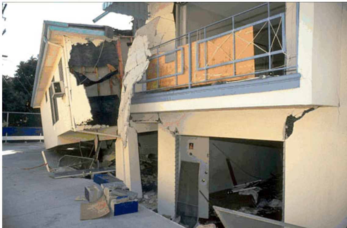
Fig.53- Colapso de um bloco de apartamentos como consequência do sismo de Northridge
