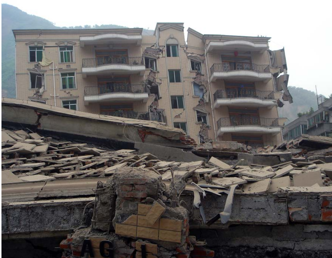
Fig.11- Comportamento indesejável do edificado após um sismo (Sichuan 2008)
