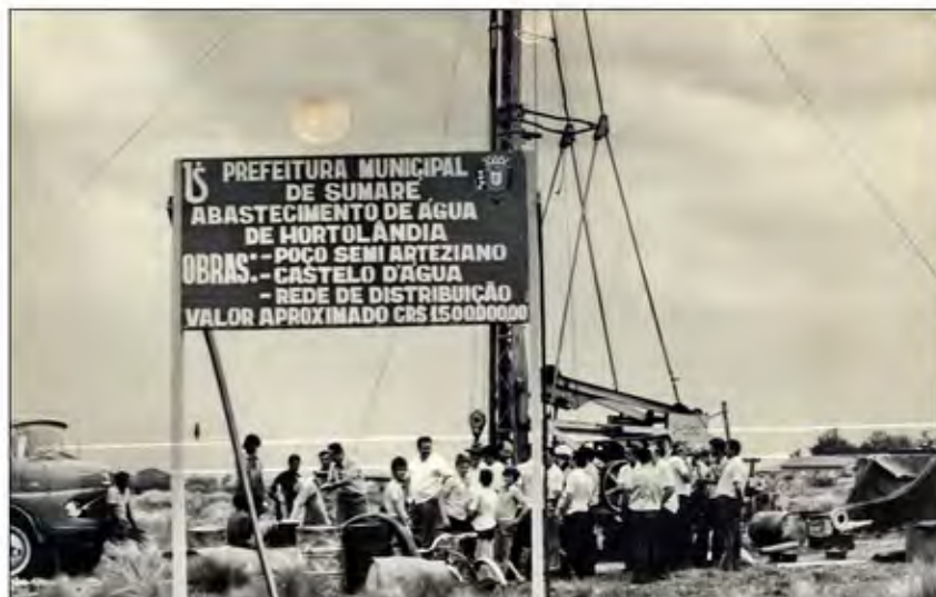
Obras para Abastecimento de Água em benefício do Distrito de Hortolândia, durante 2ª gestão "João Saldino Passarechini". Dado entre 1973-1977. Autor Desconhecido. Coleção "Memória Fotográfica", Arquivo Histórico da Associação Pró-Memória de Sumaré/ Centro de Memória "Thomas Okuma", Sumaré-SP.
