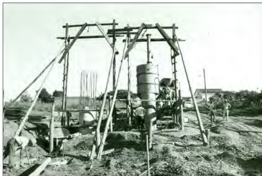
Obras para a construção do Viaduto que interliga as bairros Vila São Francisco e Nova Hortolândia, durante 2ª gestão "João Saldino Passarechini". Dado entre 1973-1977. Autor Desconhecido. Coleção "Memória Fotográfica", Arquivo Histórico da Associação Pró-Memória de Sumaré/ Centro de Memória "Thomas Okuma", Sumaré-SP.
