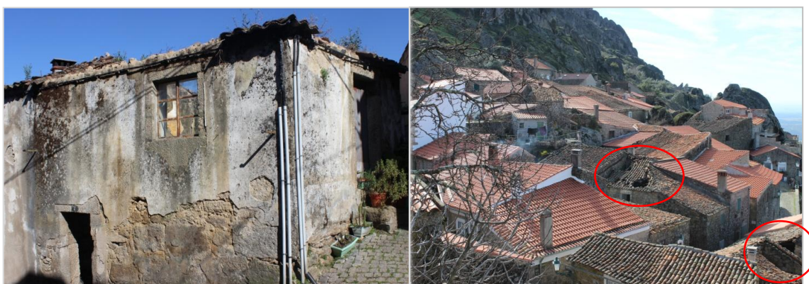
Figura 23 - Edifício muito degradado na Aldeia Histórica de Belmonte (esquerda) e com necessidades de reparação na Aldeia Histórica de Monsanto (direita)
