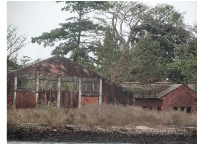
Figura 76: Ilhéu do Rei, edifício onde é proposto o refeitório do polo escolar.
