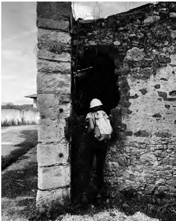
Fig. 57 | Construção em ruína na antiga ala norte setembro 2020
