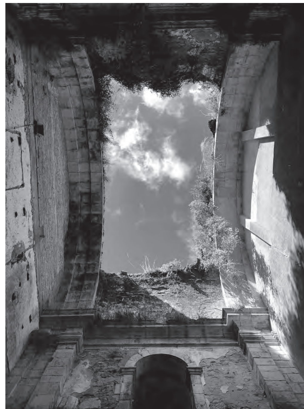
Fig. 56 | Cobertura da igreja em ruína, a céu aberto setembro 2020
