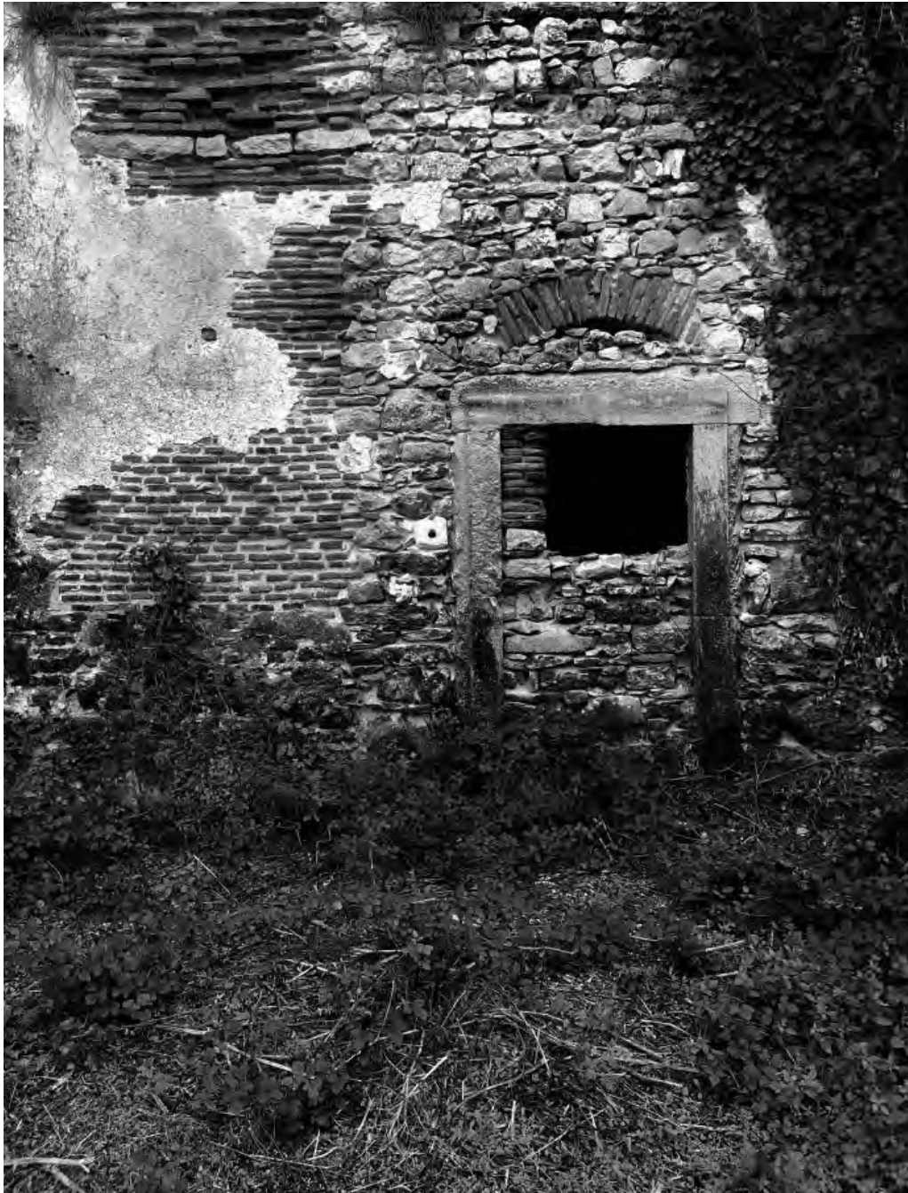
Fig. 41 | Camadas construtivas reveladas pelo estado de degradação setembro 2020
