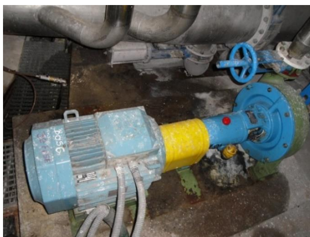
Figura 5.3. Conjunto motor-bomba mistura 3ª fase mesa inferior
