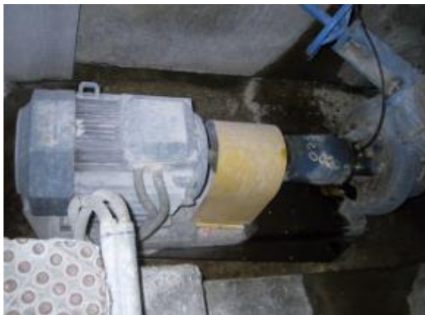
Figura 5.4. Conjunto motor-bomba vazamento tinão de mistura
