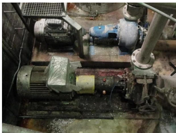
Figura 5.2. Conjunto motor-bomba mistura 2ª fase mesa inferior
