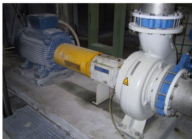
Figura 5.1 Conjunto motor-bomba mistura 1ª fase mesa inferior
