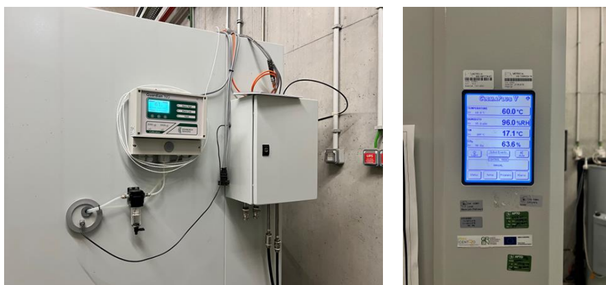
Figura 3.9- Câmara de Carbonatação
