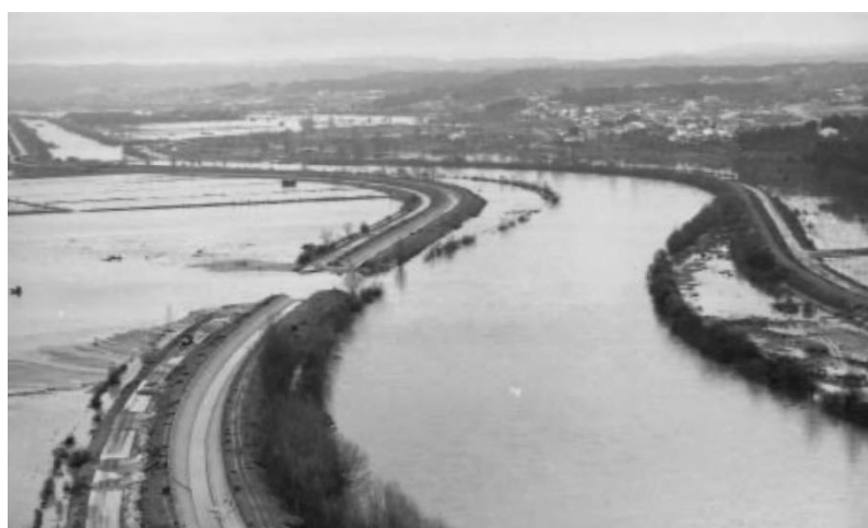
Figura 2.10 – Panorama da rotura do dique direito do canal principal (Baixo Mondego), junto a Santo Varão (Antunes do Carmo, 2004; Cunha, 2002).
