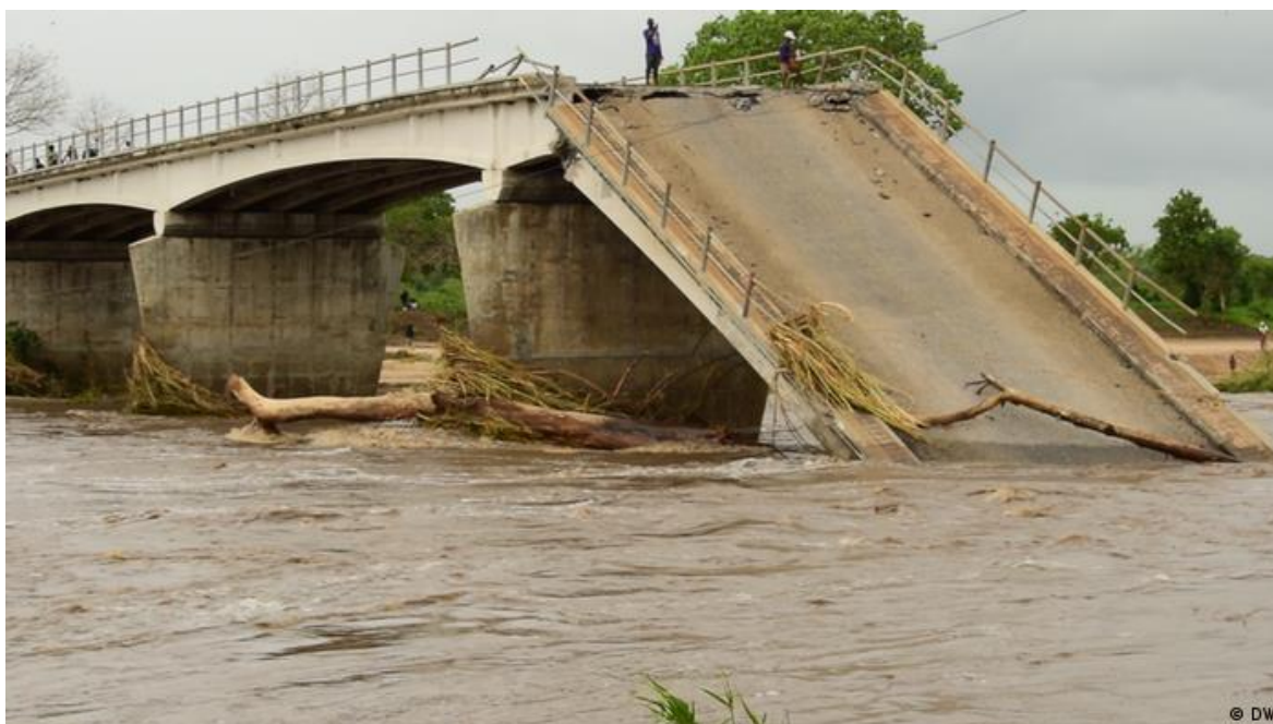
Figura 29 Destruição de infraestrutura na sequência dos ciclones Idai e Kenneth
