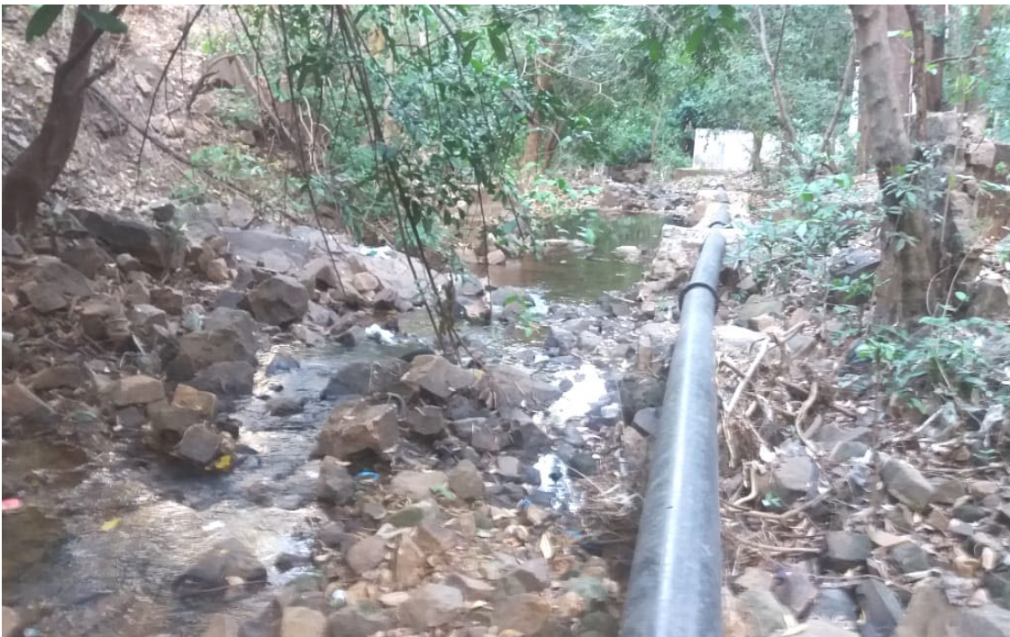
Figura 5.9 – Canalização da AGESPISA (Águas e Esgotos do Piauí, S.A), no Parque Ambiental do Pirapora – Pedro II – PI.
