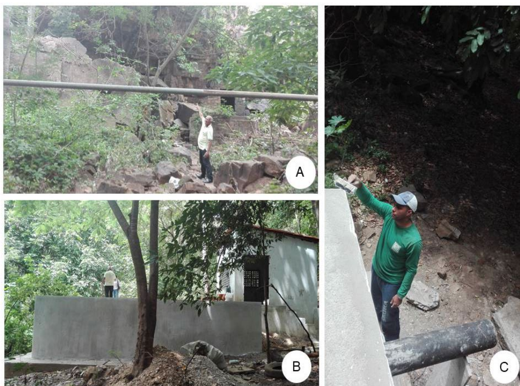
Figura 6.15: Estrutura de captação de água do Parque do Pirapora, pertencente à AGESPISA (Águas e Esgotos do Piauí, S.A). A – Prof. Afonso Getirana, que foi o guia desta visita de campo, mostrando a tubulação de ferro que transporta a água para o abastecimento da AGESPISA (Águas e Esgotos do Piauí, S.A); B – Casa da bomba d'água; C – Manutenção das estruturas físicas da AGESPISA.
