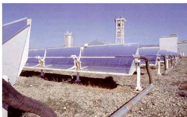
Figura 5.12: Imagens do Campo de Colectores Solares.
