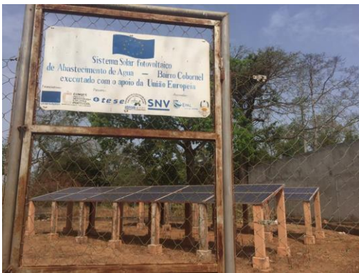
Figura 5: O sistema fotovoltaico instalado ao lado da sede da ASPAAB que suporta o bombeamento de água a cidade de Bafatá
