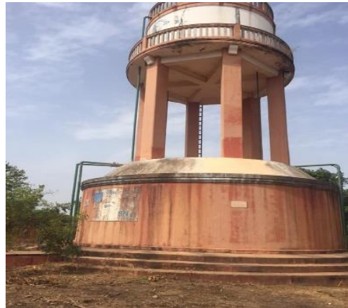
Figura 4: Uma das estações elevatórias de Bafatá
