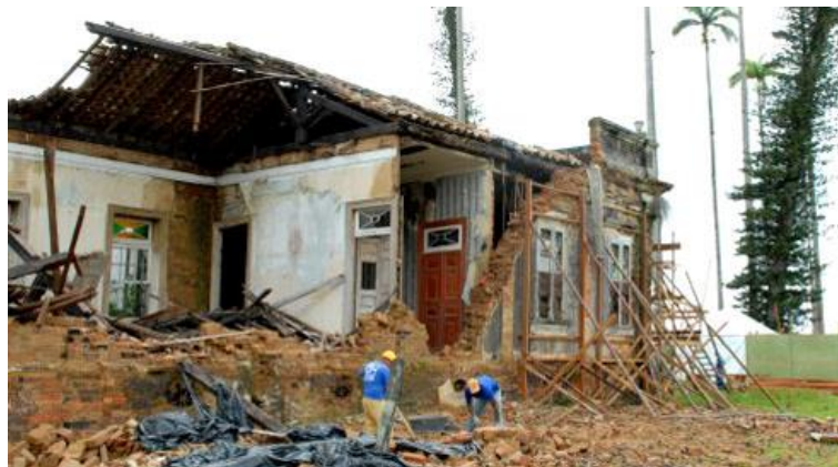
Figura 225 – Visão do lado esquerdo da fachada onde se percebe o estado de arruinação da casa.
