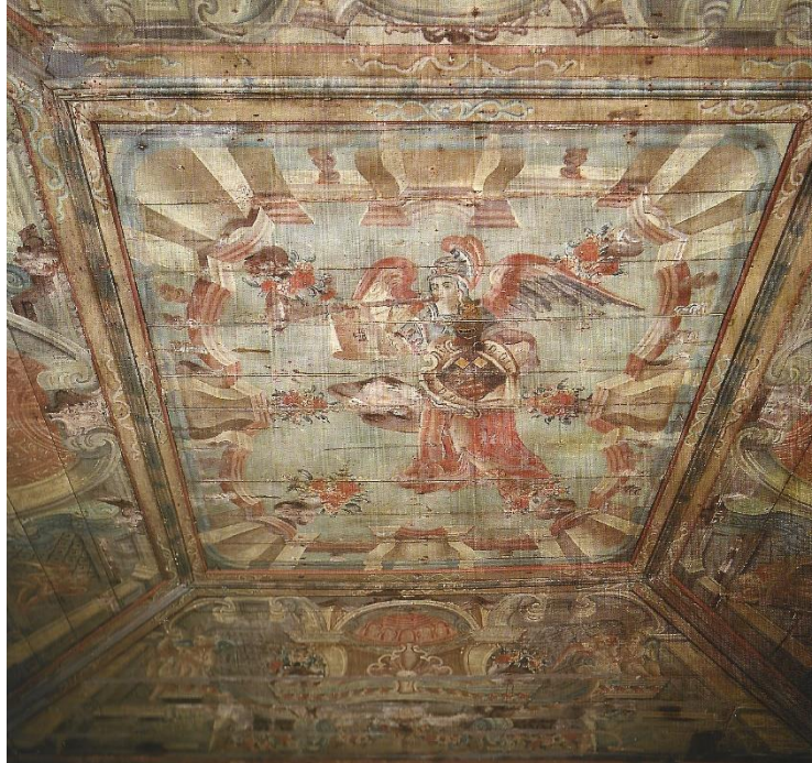
Figura 68 - Pintura do forro em técnica ilusionista. Segundo o autor, o Engenho Lagoa é um dos poucos edifícios civis a apresentar esse tipo de decoração, geralmente reservado para edifícios religiosos.
