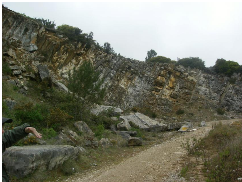
Figura 5.10 – Instabilidade do tipo “ Toppling ”, afloramento A3 (Margas e Calcários do Bajociano).
