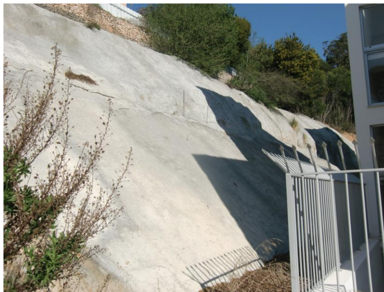
Figura 5.13 – Afloramento A37, trabalho de estabilização recorrendo a cobertura do afloramento com betão projetado que se prolonga ao longo de todo o talude na traseira do prédio.
