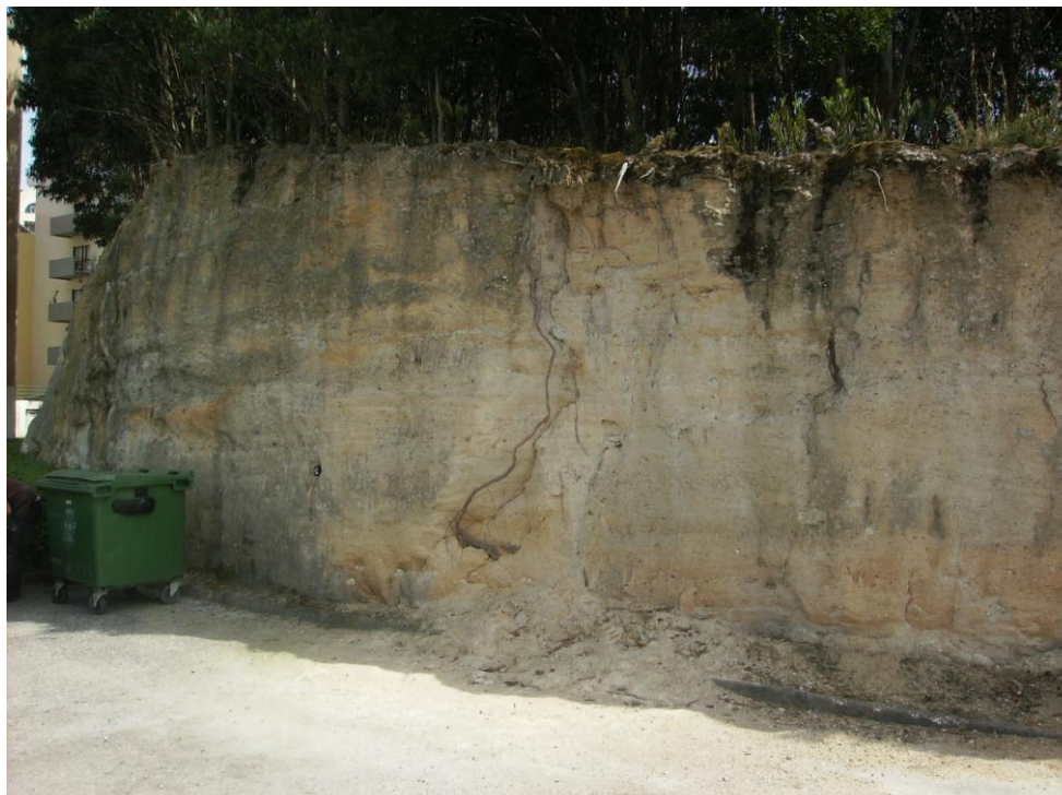
Figura 5.9 – Queda de detritos/solos no afloramento A39.
