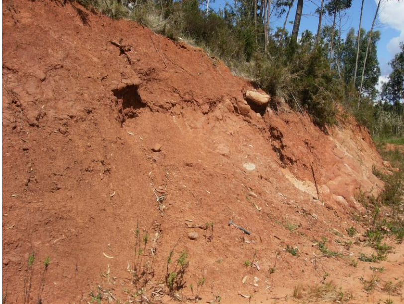
Figura 5.12 – Rotura circular, afloramento A30 (Arenitos da Boa Viagem).
